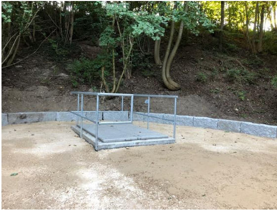
Neuer Ausseneinstieg PW Oeli, Wolfwil
